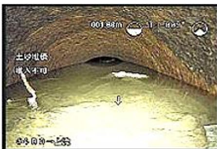
雨水が入った輸送管
