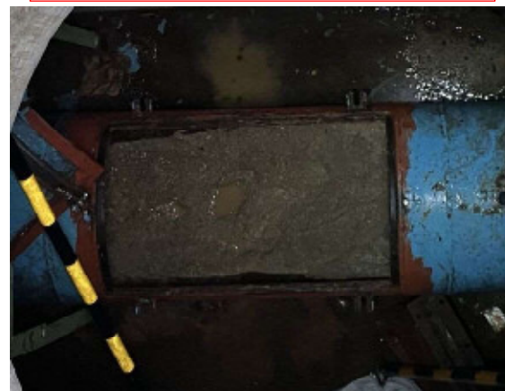
土砂堆積状況
